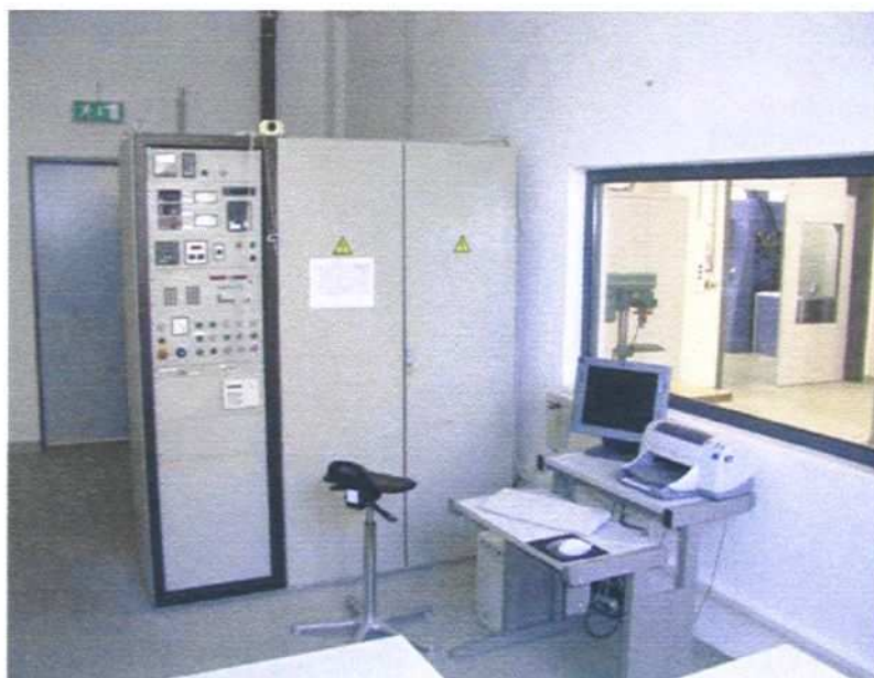
Abb. 3: Bedienraum mit Steuerschrank und Datenerfassung
